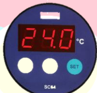
Revisar indicador de temperatura de enfriadores
